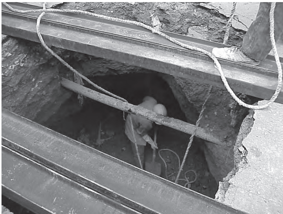
تصویر ۶-۴- ریزش قنات در یکی از محلات جنوبی تهران
