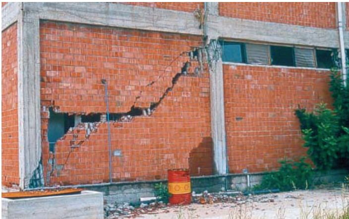
تصویر ۹-۴- آسیب دیدگی ستون‌های ساختمان (اجزای سازه‌ای) در زلزله به علت نوع، هندسه و موقعیت قرارگیری دیوارهای میان قاب (اجزای غیرسازه‌ای)
